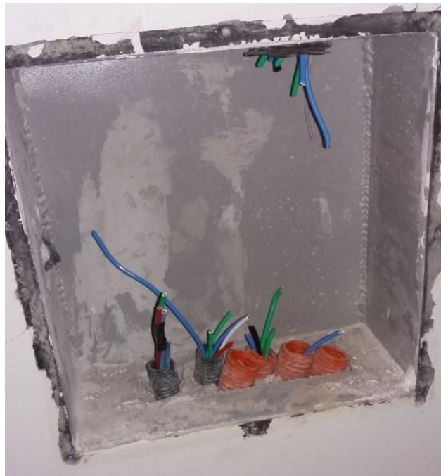
Figura 18 – Imagem dos cabeios cortados dentro da caixa de passagem – Danificada.
