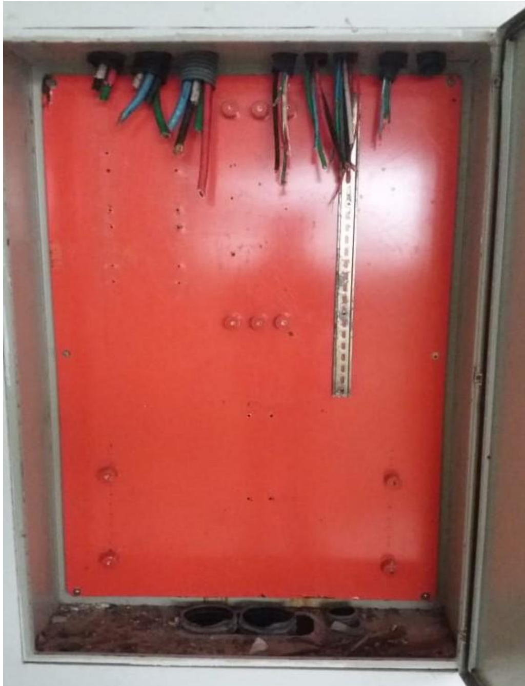
Figura 1 – QGBT existente – Danificado
