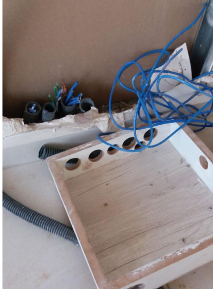
Figura 11 – Cabos de Lógica cortados
