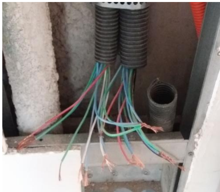
Figura 7 – Saída dos cabos dos quadros Danificados
