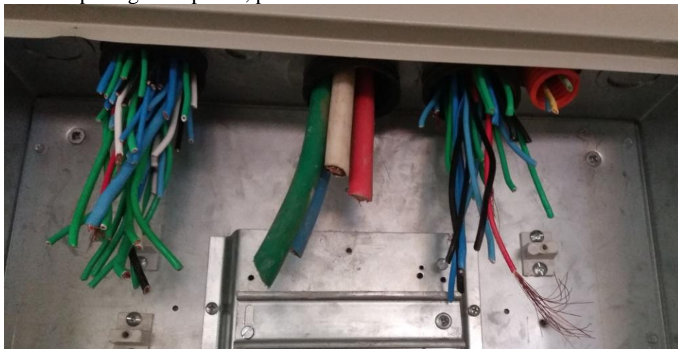
Figura 5 – Cabos cortados na entrada e saída do Quadro de Distribuição
