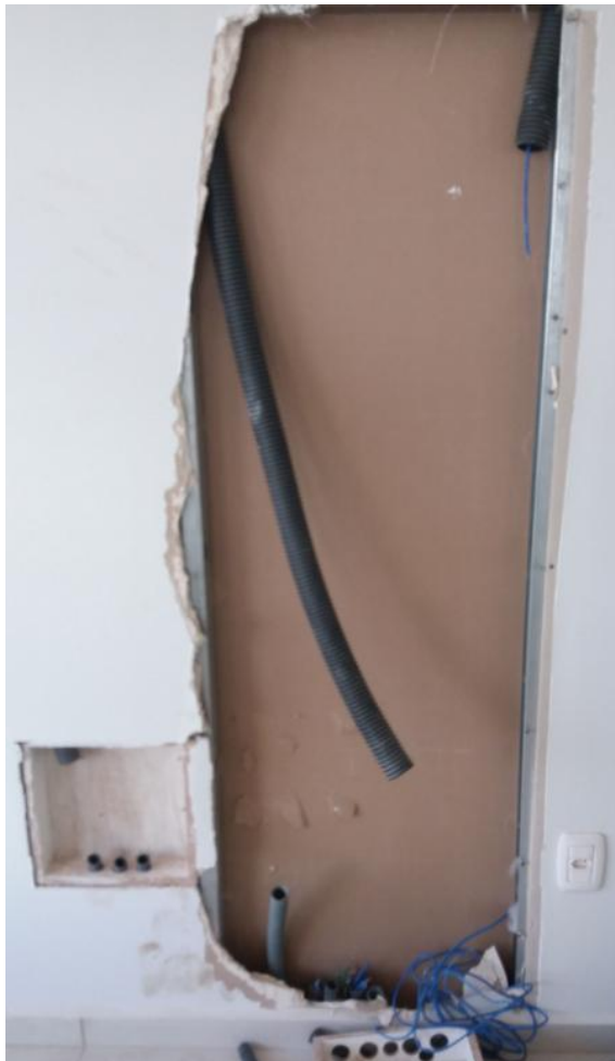
Figura 12 – Cabos de Lógica cortados
