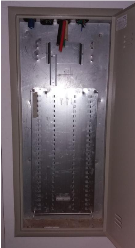
Figura 6 – Quadro de Distribuição Danificado
