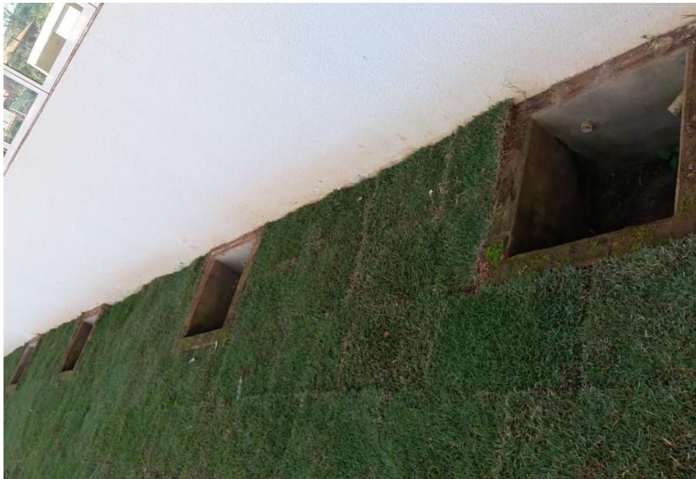
Figura 10 – Caixas de Passagem Externas
