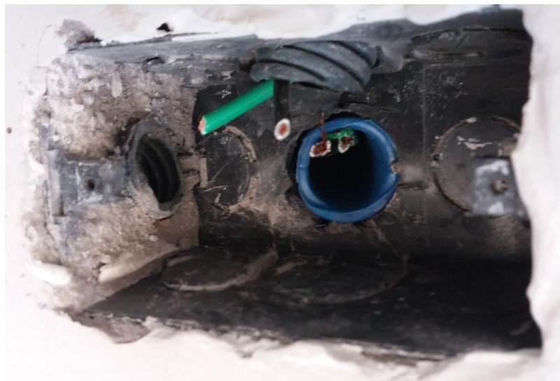
Figura 16 – Imagem dos cabeamentos cortados dentro da caixa 4x2 – Danificada.
