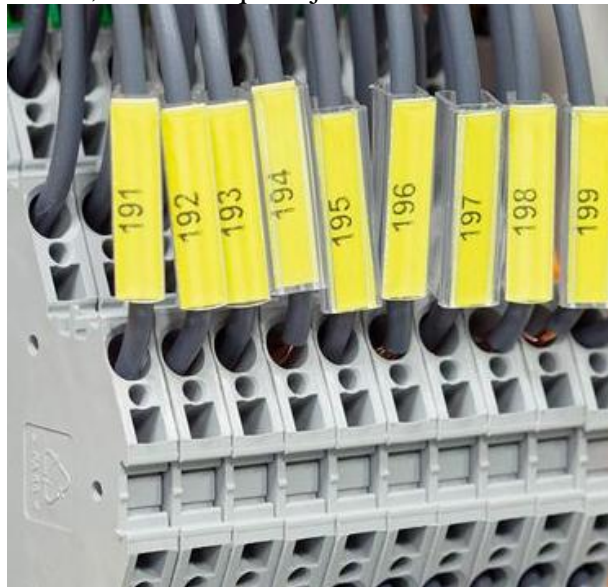
Figura 13 – Imagem ilustrativa das identificação dos cabos
