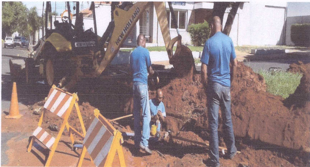
Rede coletora de água pluvial – imagens do Google.
