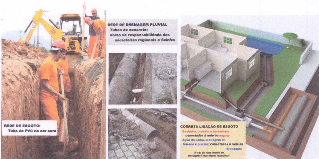
Rede coletora de água pluvial – imagens do Google.
